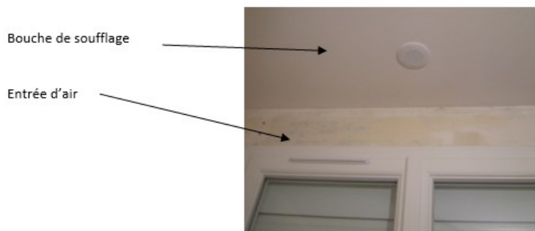
Fig. 19 - cas de présence de soufflage (double flux) et d'entrée d'air inutile et préjudiciable
